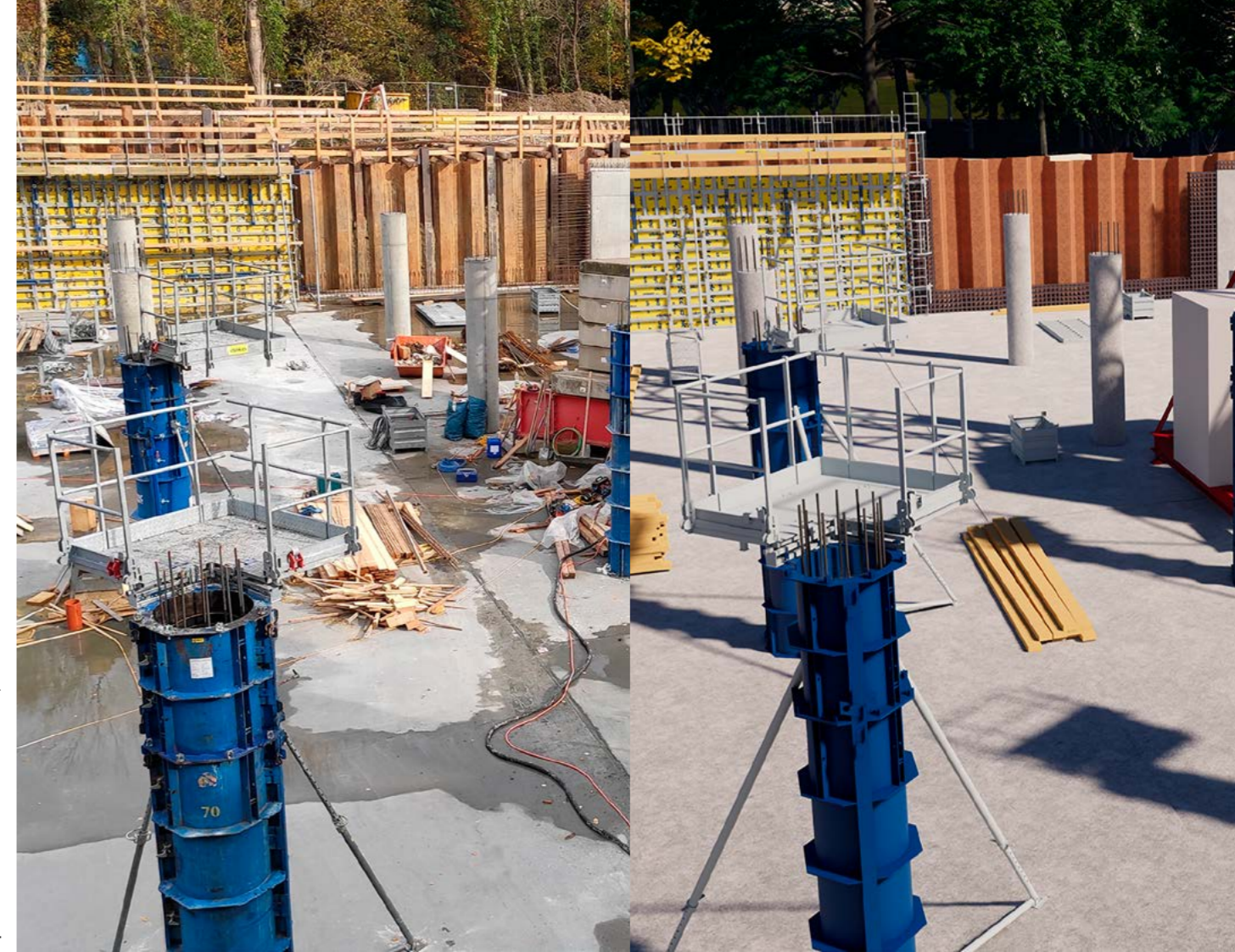
Speicherbecken Gelbe Haide; © Doka Österreich GmbH
